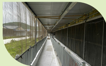
Hệ thống tấm làm mát và lưới chắn côn trùng lắp đặt tại chuồng nuôi.
